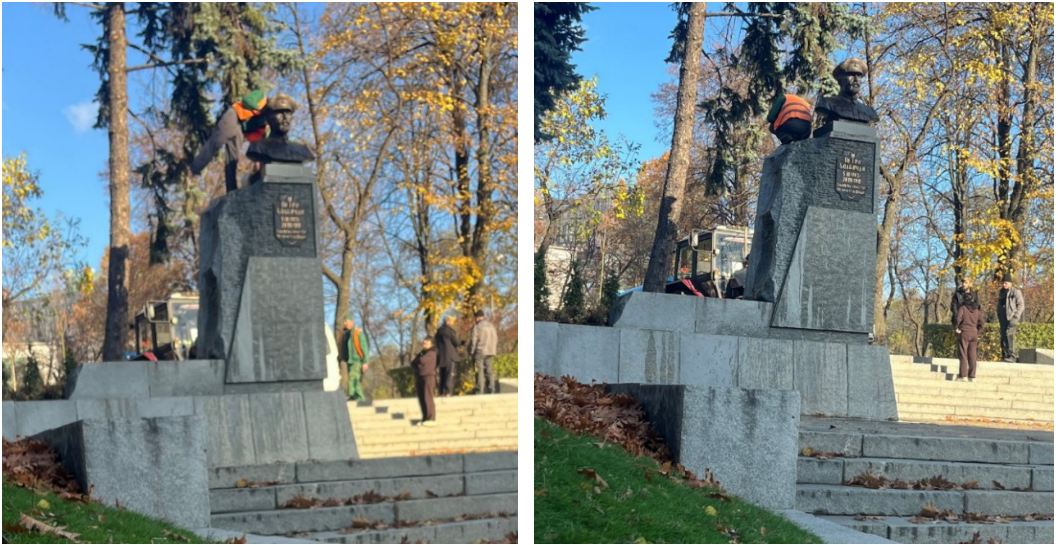
Рис. 2. Виконання робіт на пам'ятнику з порушенням техніки безпеки
