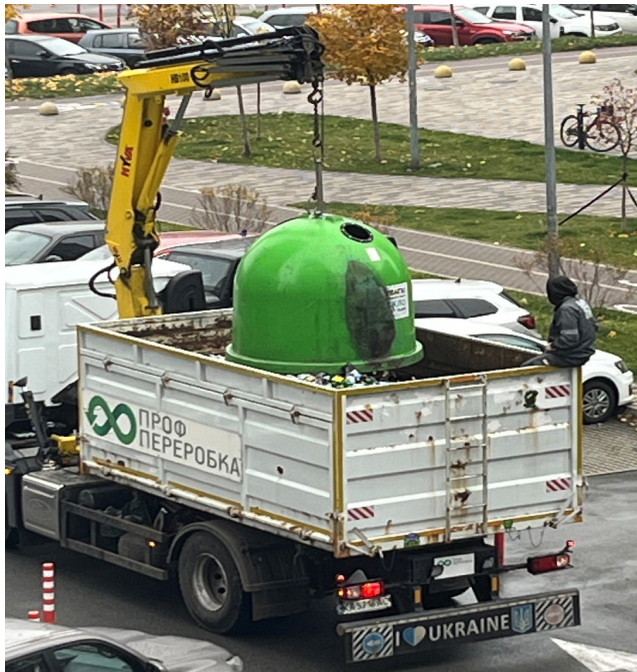
Рис. 4. Виконання робіт за допомогою вантажопідіймного пристрою з порушенням техніки безпеки
