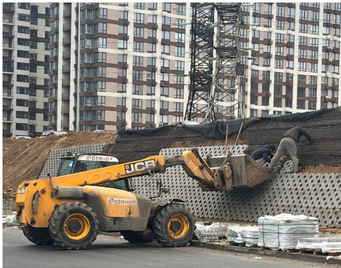
Рис. 3. Виконання робіт із ковша телескопічного навантажувача JCB з порушенням техніки безпеки
